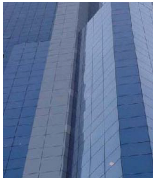
Exemplo de erro e instalação. Chapas em direções diferentes
